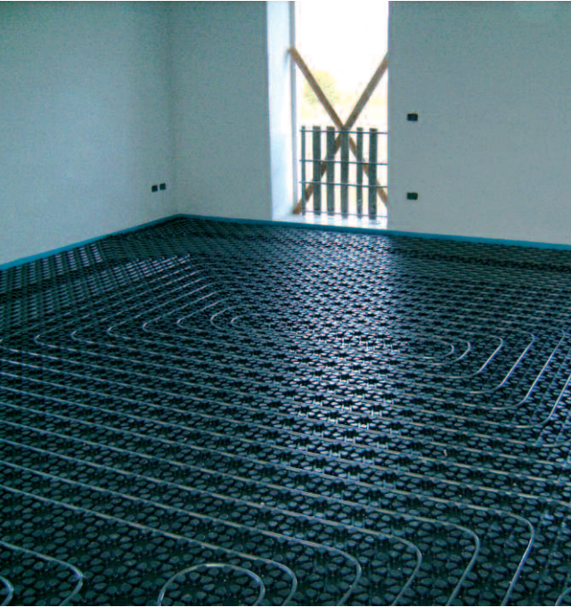
Impianto di riscaldamento a pavimento.
